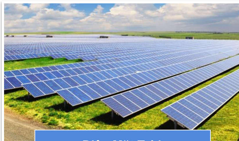
Điện Mặt Trời Trang Trại - Solar Farm
